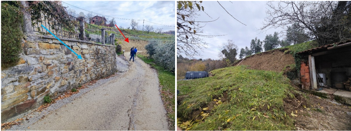
Slika 5 (leva slika): Usad v okolici objekta Hlevnik 5a in razpokan podporni zid.
