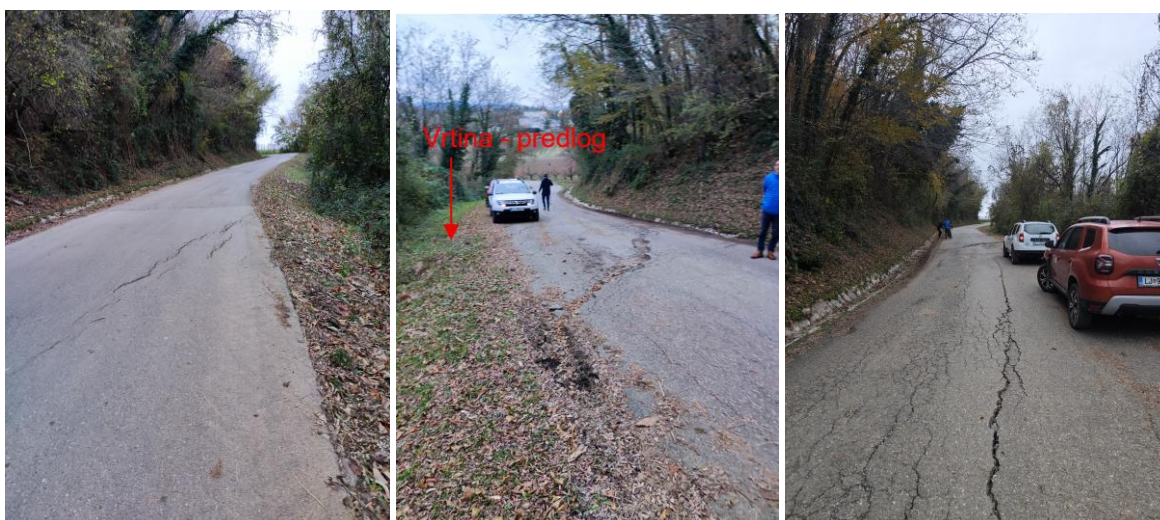
Slika 1: Odlomi robovi plazljivega območja na cesti v Fojano. Leva slika zgornji odsek ceste, sredinska in desna slika srednji odsek ceste.
