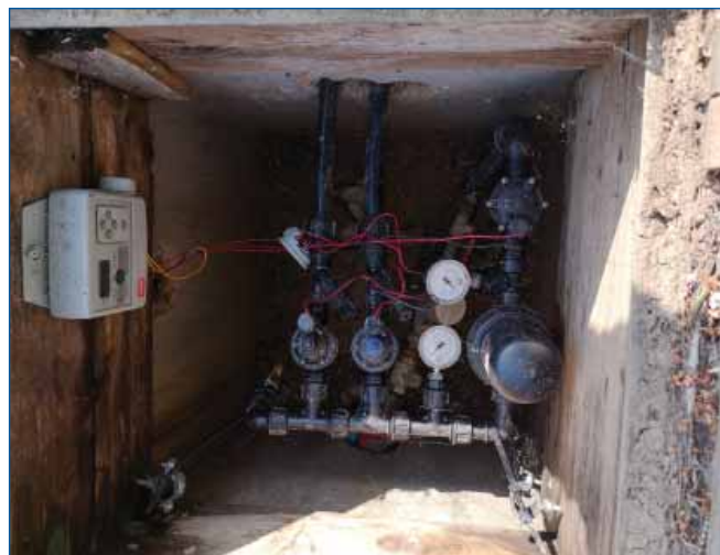
Zeleni priključek - vodovod, filter in razvod
