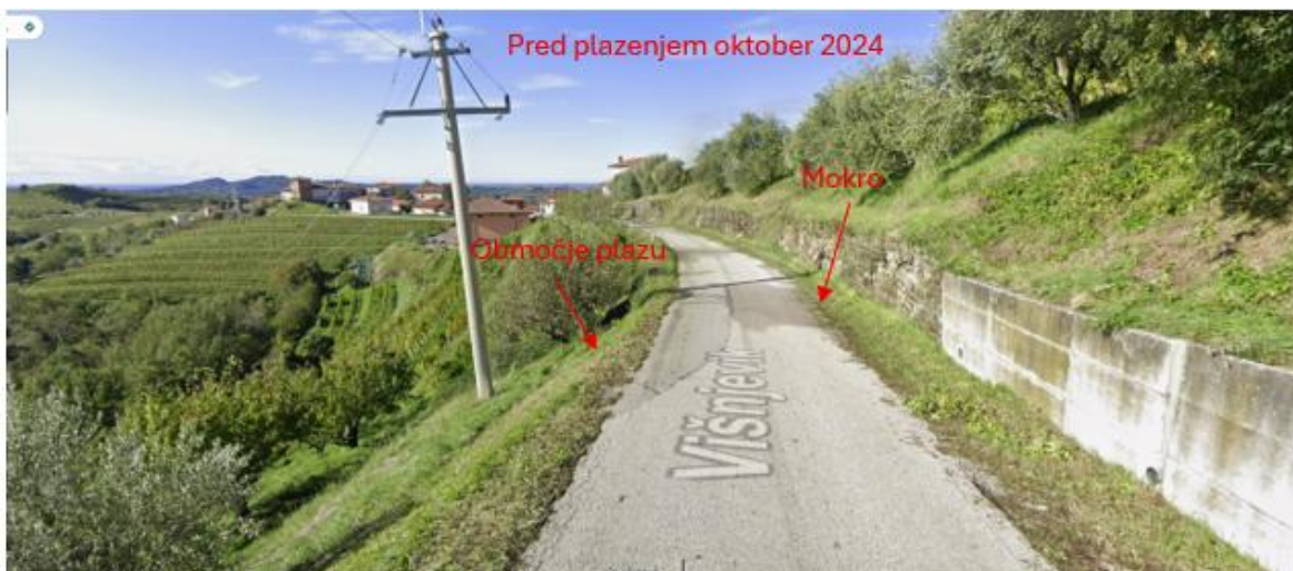
Slika 1: Stanje cestišča pred plazom, vidna neeobotnost terena, krpa asfalta in zamakanje pri stiku krpe asfalta, vir slike google maps, posneto oktobra 2024.
