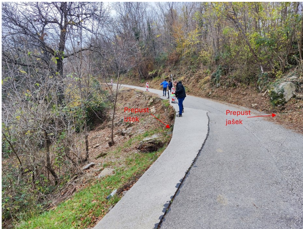
Slika 1: Osrednji in zahodni del plazljivega območja (zahod je v smeri po cesti nazaj).
