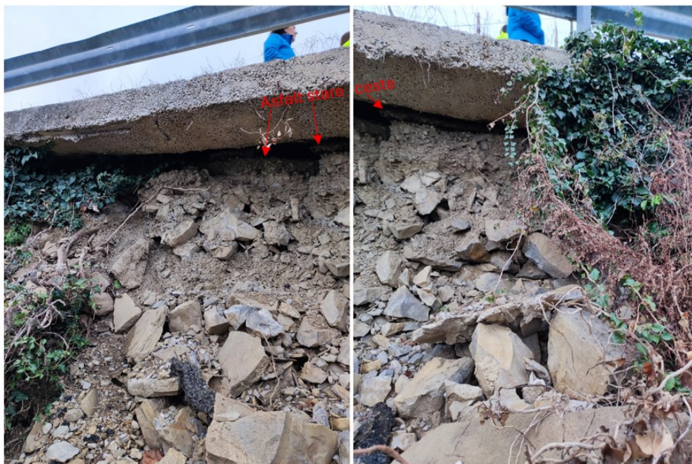
Slika 5: Podor pod cestiščem, ki izgleda podobno kot porušitev zaradi specifičnega loma tal.
