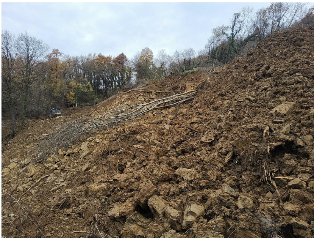
Slika 10: Pogled proti cesti (v smeri proti SZ) približno iz roba akumulacije glavnine materiala.
