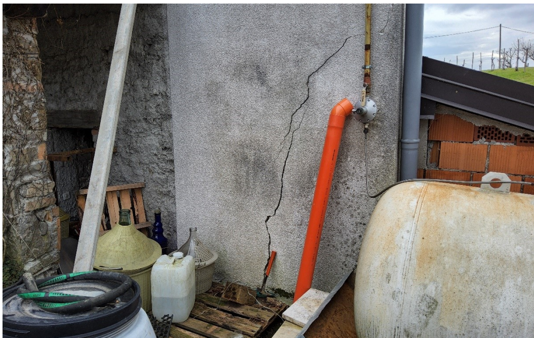
Slika 8: Poškodbe na stanovanjskem objektu na naslovu Neblo 30.
