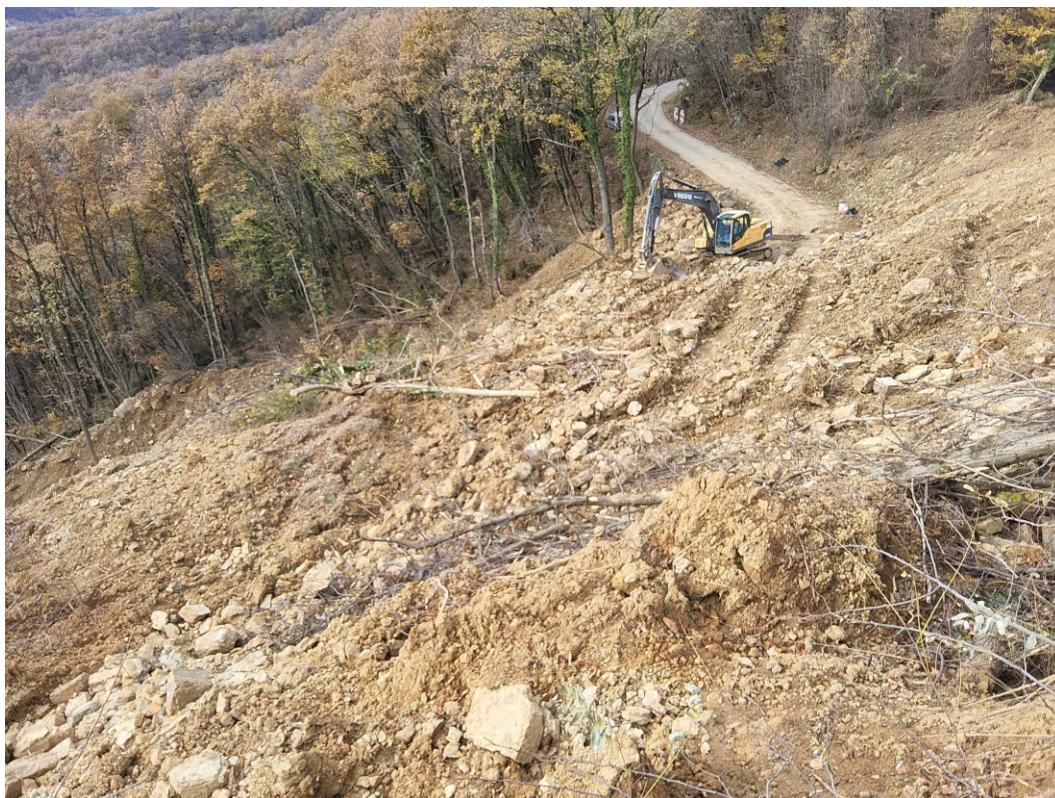
Slika 9: Pogled proti skrajnemu zahodnemu delu plazišča pod lokalno cesto.
