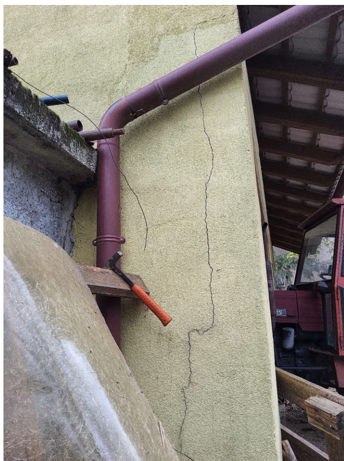
Slika 7: Poškodbe na gospodarskem objektu.
