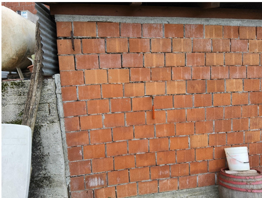
Slika 6: Poškodba na prizidku.
