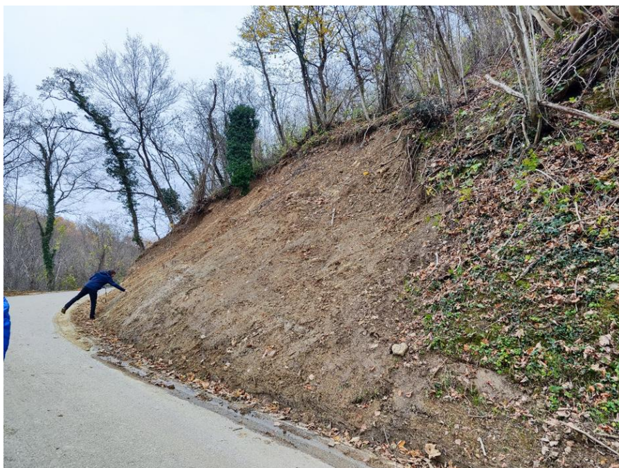
Slika 1: Slika prvega plazu nad cesto.
