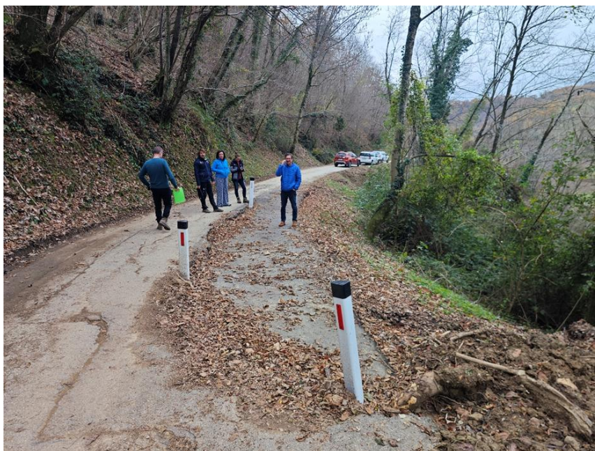
Slika 1: Posedek na cesti, plaz, del širine ceste je neprevozen.
