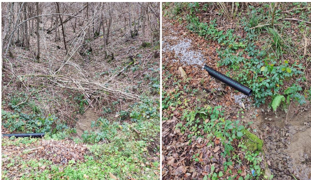
Slika 3 (leva slika): Zahodni hudournik z iztokom drenažne cevi v hudournik.
