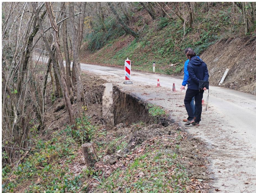
Slika 1: Pojav pod cesto.
